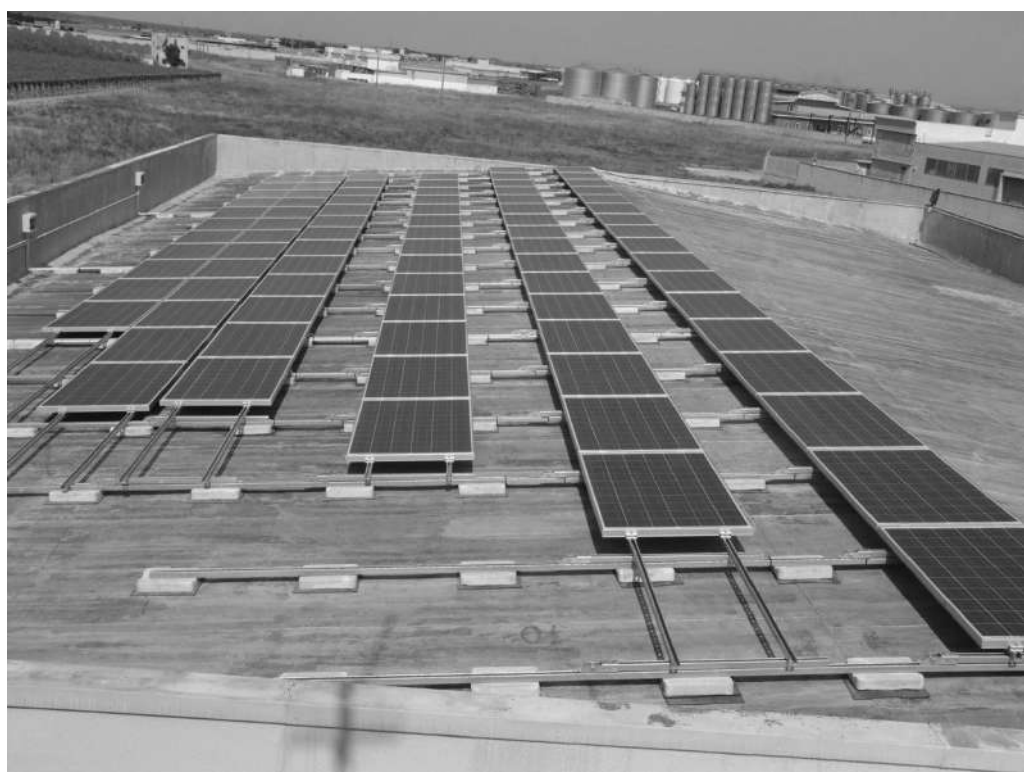
Pannelli fotovoltaici della ditta Di Biase.
