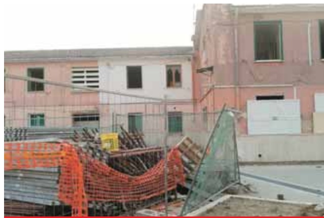
11 luglio 2015. Le palazzine lasciate per consentire la ristrutturazione con i vetri delle finestre in frantumi
