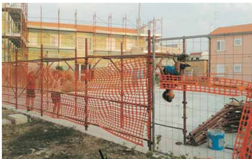
11 luglio 2015. Cantiere lasciato senza alcuna norma di sicurezza aperto in bella vista
